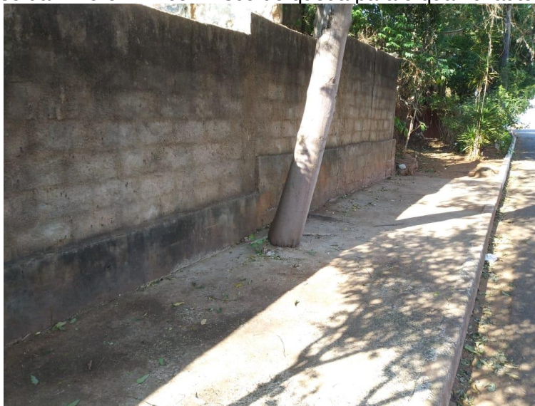
Figura 4: Base da Árvore nº 2 com risco de queda para o qual foi autorizado o corte.
